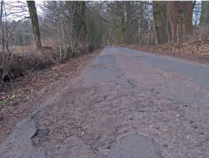
Das Auftragen einer notdürftigen Teerdecke im Peiner Hag dürfte bald wieder solche Krater zulassen.
